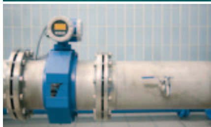
Am Zähler rechts lässt sich der momentane Wasserverbrauch kontrollieren.
